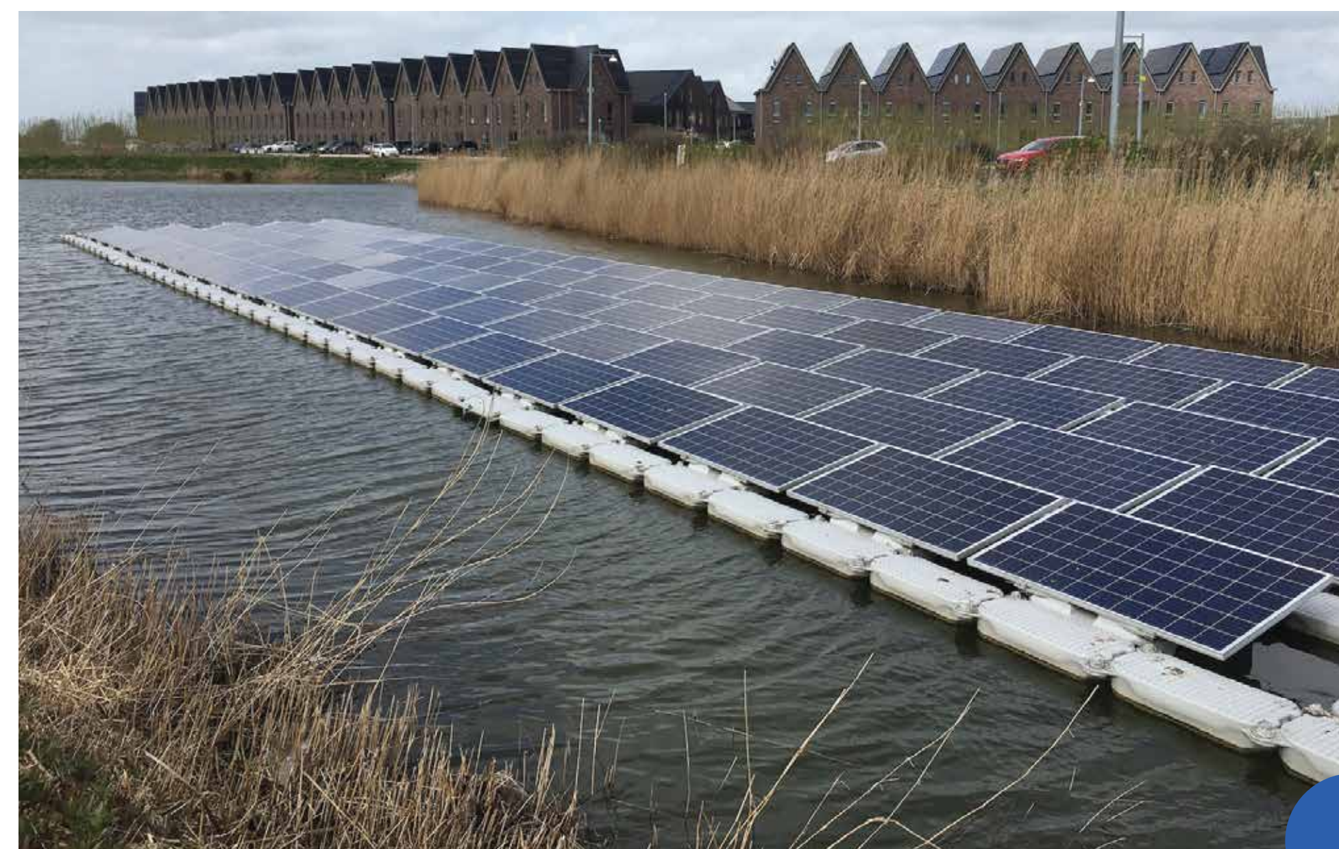
Eilanden met drijvende zonnepanelen
